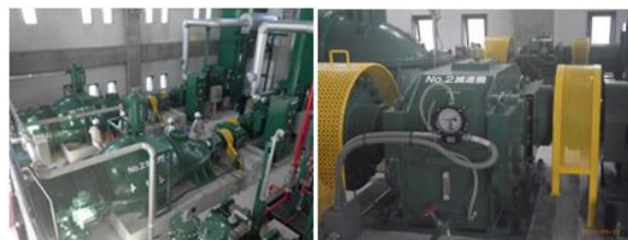
写真-5.7 排水機場ポンプ設備（左）と減速機（右）
