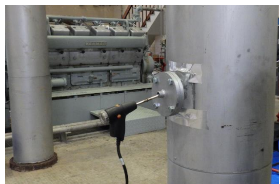
写真-6.4 排気ガス測定口と挿入された測定プローブ
