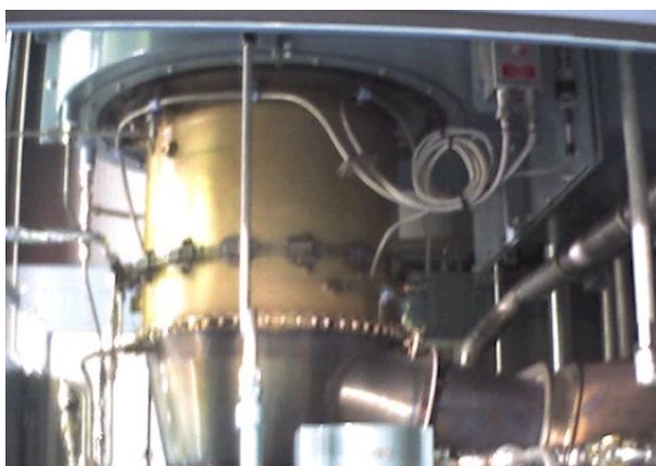
写真-5.4 ガスタービン燃焼器側部外観
