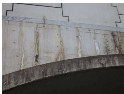
(b) ヒンジ式アーチカルバートウイングのひびわれの例
