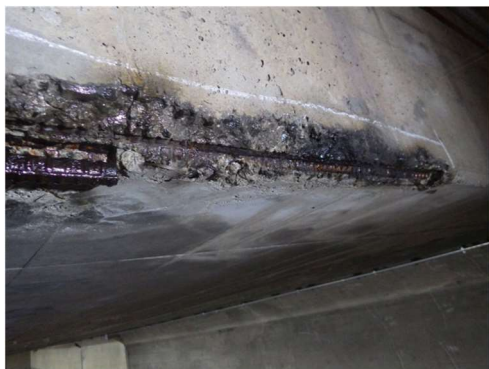
(a) コンクリートのうき・剥離および鉄筋露出
