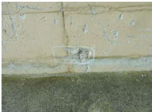
写真-2 コンクリート欠損の例
