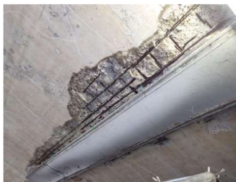
(d) 導水工付近の剥離・鉄筋露出
