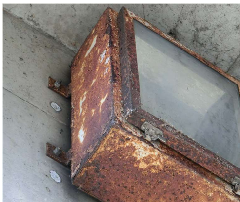
写真-3 照明器具の腐食の例
