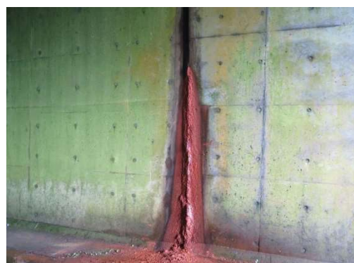
(b) 継手部からの土砂の流入
