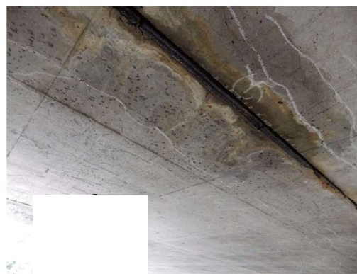
(c) 炭酸カルシウムが浮き出た例
