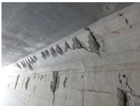
写真-4 うき・剥離のたたき落とし後の様子の例
