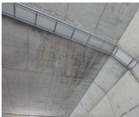
写真-3 導水工からの漏水を契機にした変状の進展の例
