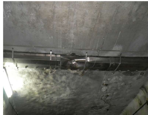
(a) 導水工の破損による漏水
