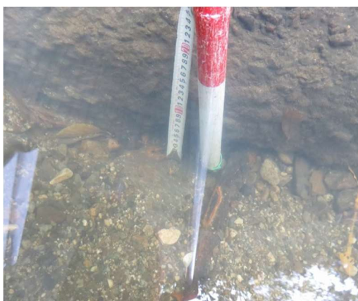
写真-8 底版直下の洗掘による空洞
