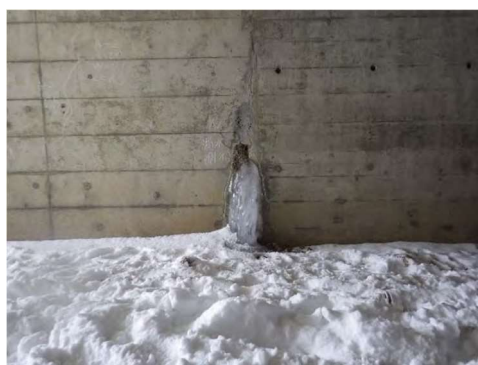
(b) 欠損部からの発生が考えられる漏水
