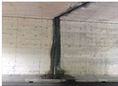
(a) 継手部材の劣化と漏水
