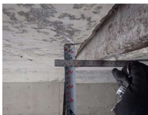
(b) 鉛直方向の段差
