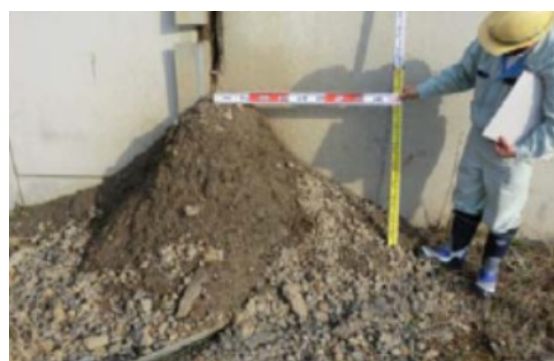
写真1 盛土材のこぼれ出し状況
