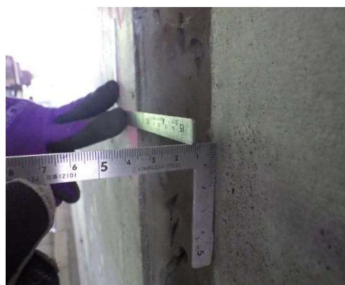
(c) 水平方向の段差
