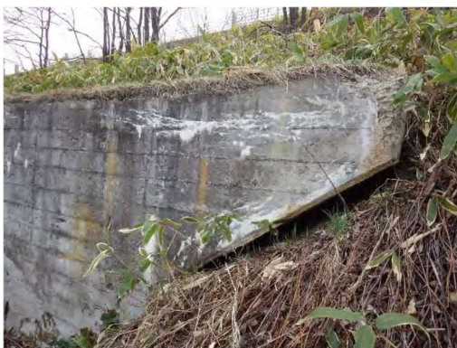
(c) 盛土とウイングの隙間
