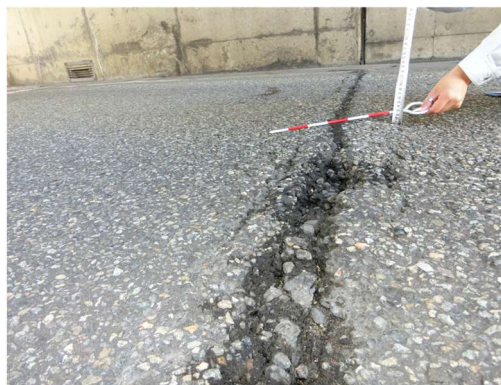
(a) 継手位置に沿った亀裂・段差
