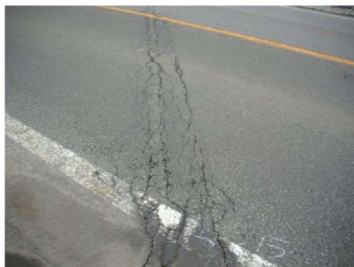
(a) カルバートと盛土の境界に沿った亀裂
