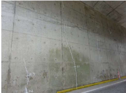
写真-2 側壁の鉛直方向ひびわれの例
