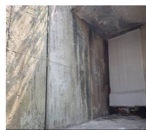
(b) 桁端部水シミ跡
