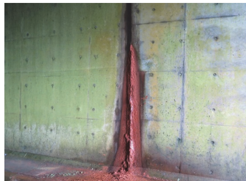
(b) 継手部からの土砂の流入
