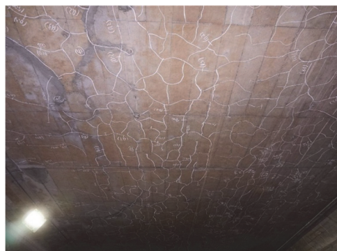
写真-1 亀甲状のひびわれの例
