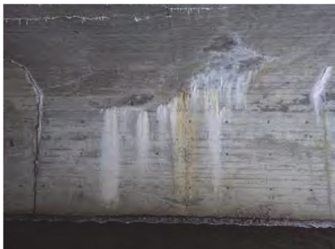
(a) 貫通ひびわれや打継目からの発生が考えられる漏水
