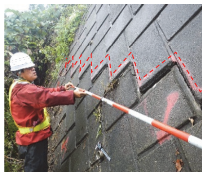
(a)目地に沿ったひび割れ(谷積み) 15)
