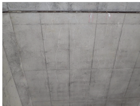
(a) 上載荷重によると考えられる軸方向ひびわれ (本写真は活荷重による例)
