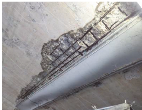
(d) 導水工付近の剥離・鉄筋露出
