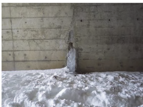
(b) 欠損部からの発生が考えられる漏水
