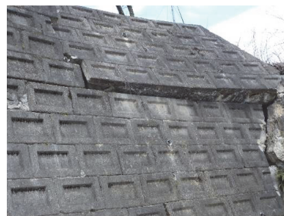
(c)目地に沿ったひび割れ(布積み)
