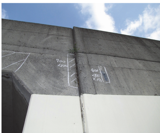
(b) カルバートとウイングの表面の段差
