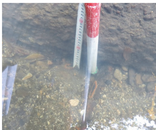
写真-8 底版直下の洗掘による空洞
