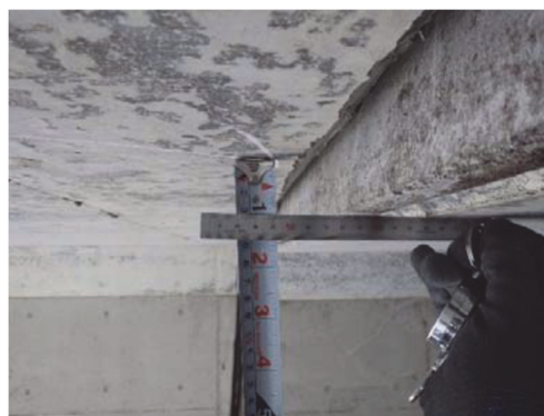
(b) 鉛直方向の段差
