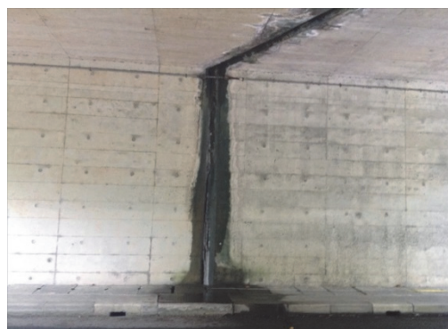
(a) 継手部材の劣化と漏水
