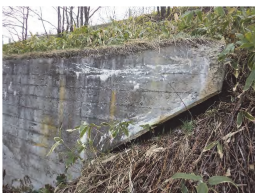
(c) 盛土とウイングの隙間
