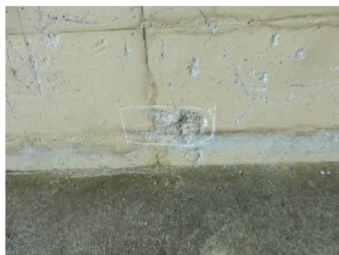
写真-4 コンクリート欠損の例
