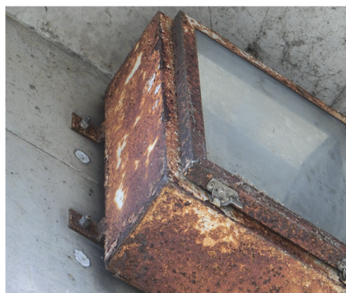
写真-3 照明器具の腐食の例
