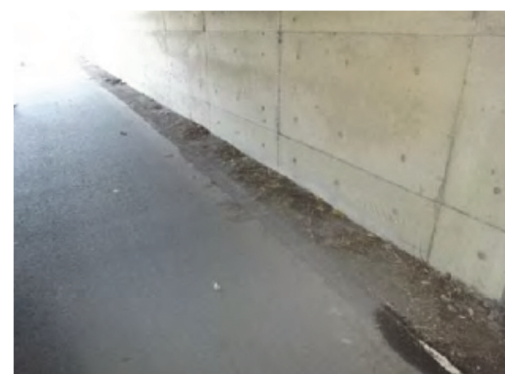
(b) 排水溝の土砂詰まり
