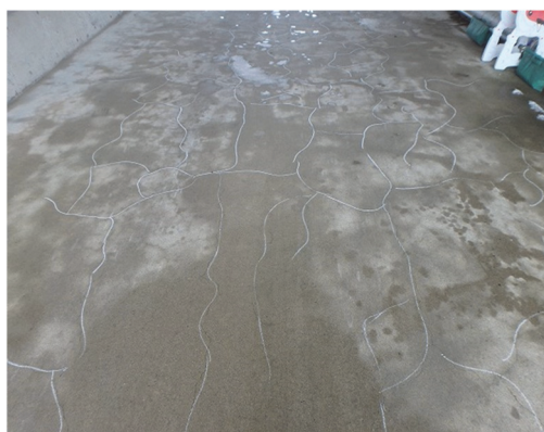
(b) 凍結融解による亀裂
