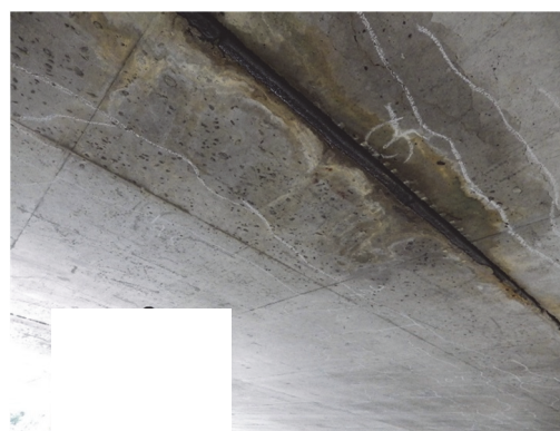
(c) 炭酸カルシウムが浮き出た例
