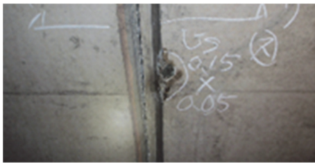
写真 2-1 目地沿いに発生するうき・はく離の例
