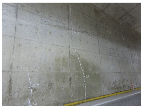
写真-2 側壁の鉛直方向ひびわれの例
