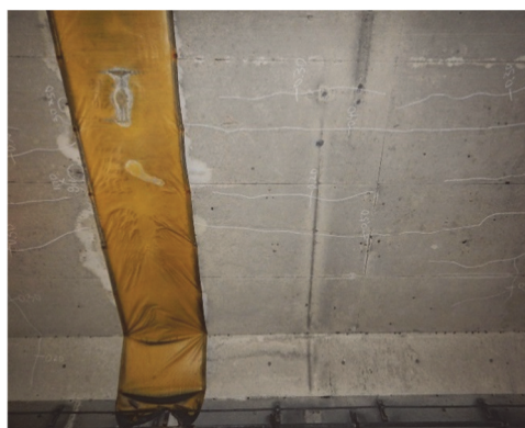
写真-2 補修後の継手部からの漏水の例
