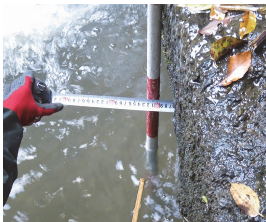
写真-10 底版直下の洗掘の例
