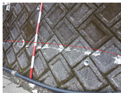
(b)ブロックを貫く直線状のひび割れ(布積み)
