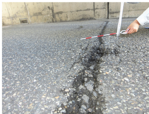
(a) 継手位置に沿った亀裂・段差
