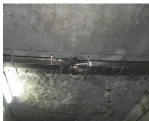
(a) 導水工の破損による漏水
