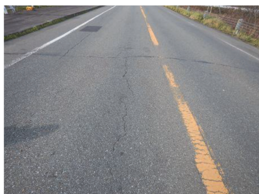
(b) 上部道路縦断方向も含む亀裂
