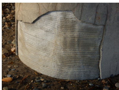
写真-7 2層施工を起因とする保護モルタルの剥落事例
