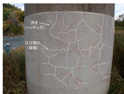
写真-3 ひび割れを伴う浮き
