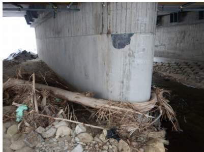
(a) 洪水時流下物の衝突による剥落
