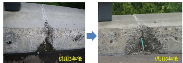
写真-1.1 地覆に生じた収縮ひび割れから凍害が進行した事例
