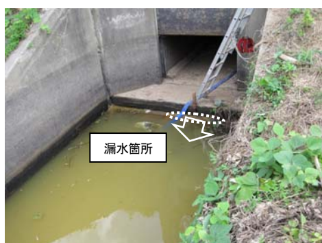
写真-4 函体下の漏水状況
