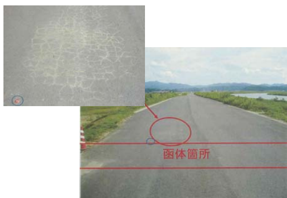
写真-5 天端舗装の亀甲クラック
