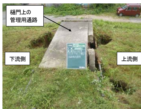
写真-3 陥没状況
