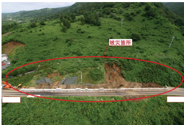
写真-3 海成段丘堆積物からなる切土のり面の崩壊事例（管轄事務所提供）
