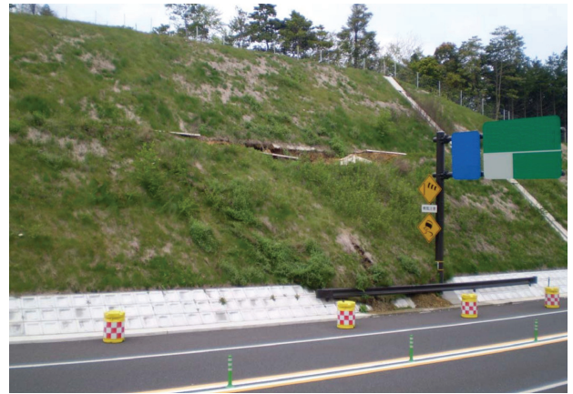
写真-4 開通約1年後の切土のり面の崩壊事例（管轄事務所提供）
