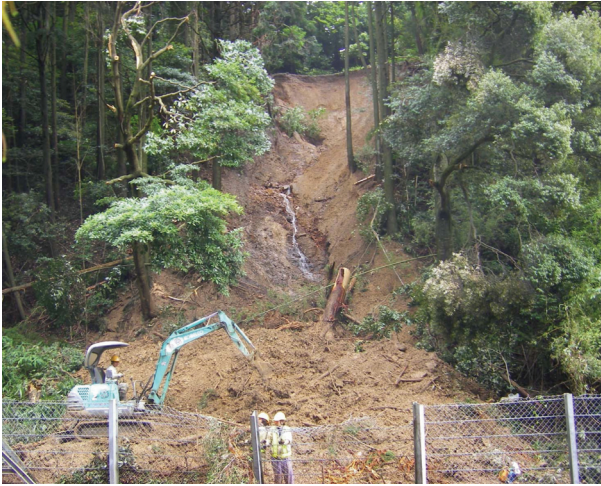
写真-5 集中豪雨による自然斜面の崩壊事例（管轄事務所提供）
