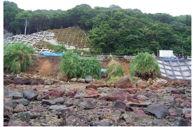
写真-7 路肩崩壊の事例（管轄事務所提供）
