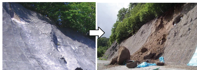
(地震により亀裂発生) (約1ヶ月後に崩壊)
