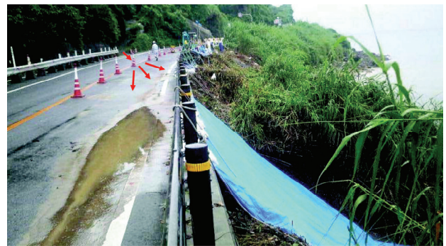
写真-8 私道からの表流水の痕跡（矢印）（管轄事務所提供）
