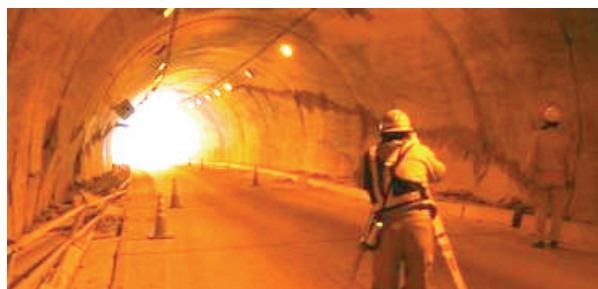
写真-1 木沢トンネルの地震被害
