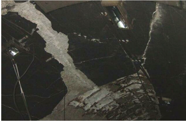
写真-2 和南津トンネル天端部の変状
