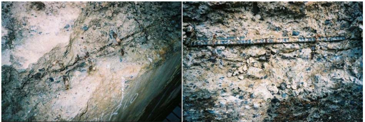
写真4.2. B橋の損傷状況(上段：ひび割れ状況，下段：鉄筋破断状況)
