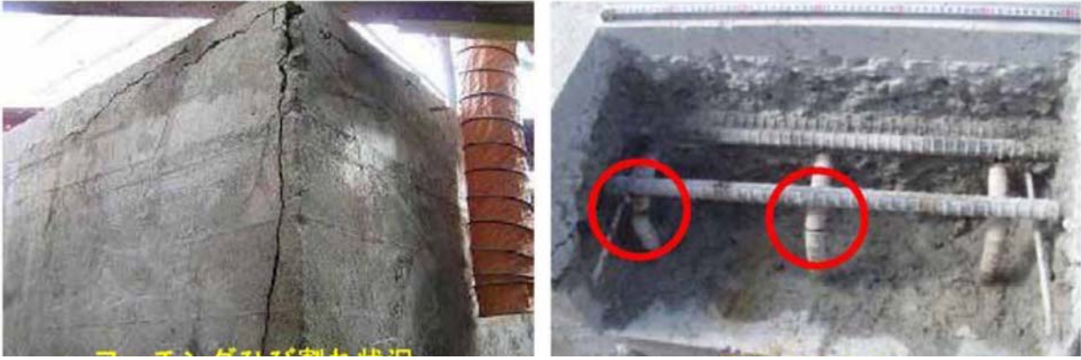
写真4.4. D橋の損傷状況(左：側面のひび割れ状況, 右：隅角部の鉄筋破断状況)
