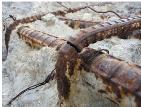
写真4.3. C橋のフーチング隅角部の鉄筋破断
