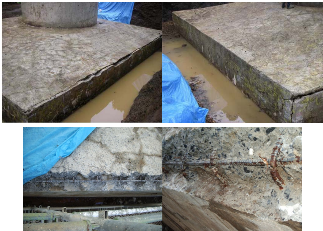
写真4.1. A橋の損傷状況(上段：ひび割れ状況，下段：鉄筋破断状況)
