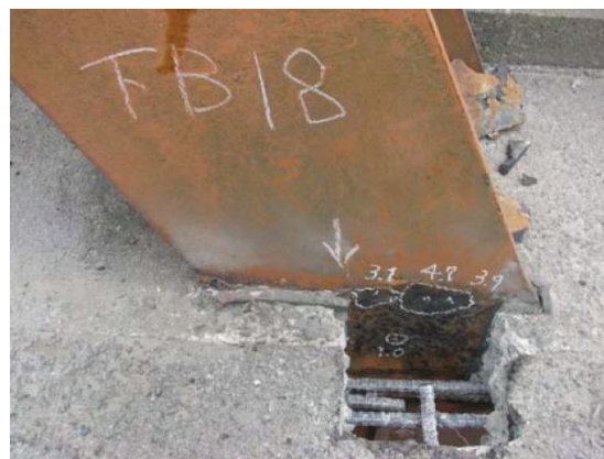
写真-3.1 コンクリート中に埋め込まれた鋼材の腐食欠損現場での適用状況
