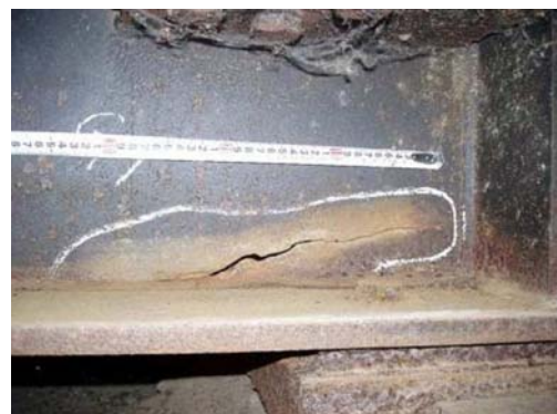
(b) ソールプレート溶接部(主桁ウェブに進展)
