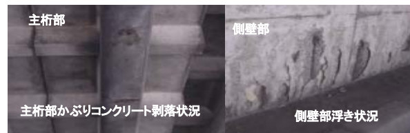
写真-III 太平洋側の覆道の損傷状況
