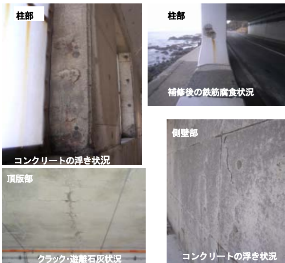
写真-I 日本海側の覆道の損傷状況
