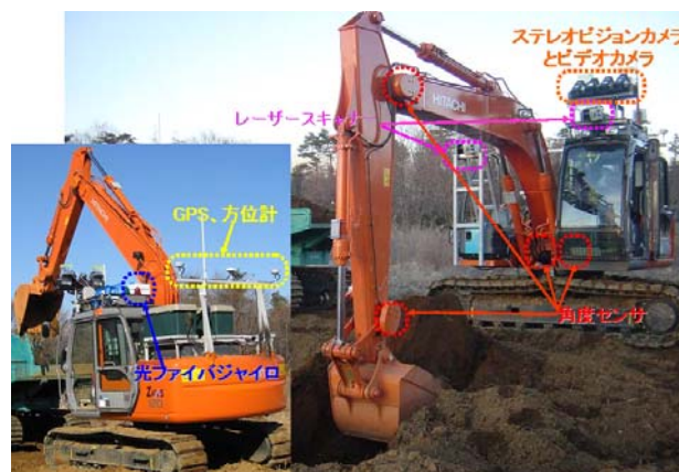
写真-1 現システムに装備している各センサー
