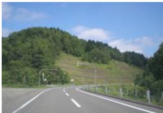
写真-6.2 植生回復が進まない積雪寒冷地の切土のり面
