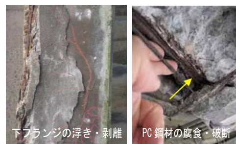
写真-3.2.2 損傷状況
