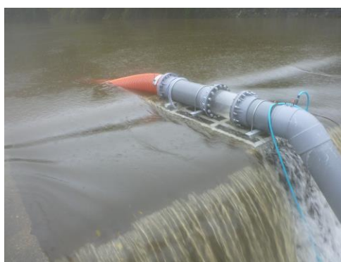
図-104 試験準備途中の出水状況（貯砂ダム天端）
