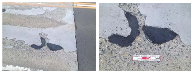
写真 3-2 補修をやり直した事例（路線 F）
