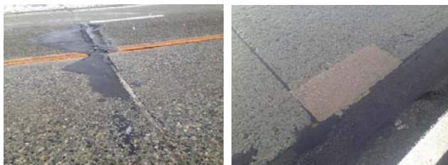
(a) 加熱合材 (b) 超速硬セメント系材料 写真 3-1 角欠けの補修事例（路線 D）
