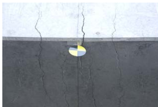
写真-2 頂版のひび割れ状況(G-CC-E3,000)
