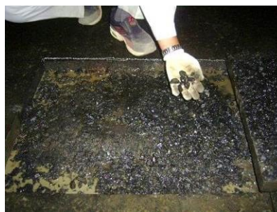
写真 4.4-1 水分の浸入による基層のはく離
