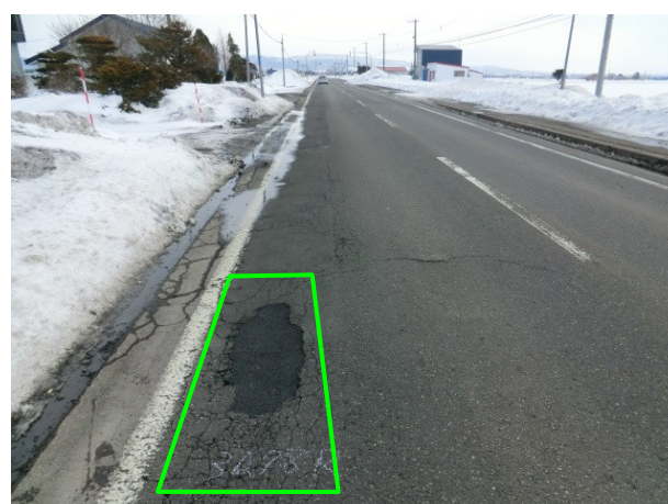
写真3.3-3 写真3.3-2と同一箇所の目視調査時状況 (ポットホールが発生し穴埋めされている)
