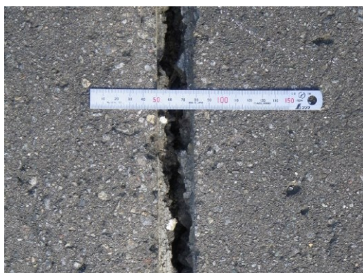
写真4.3-1 既設アスファルト舗装のひび割れ箇所
