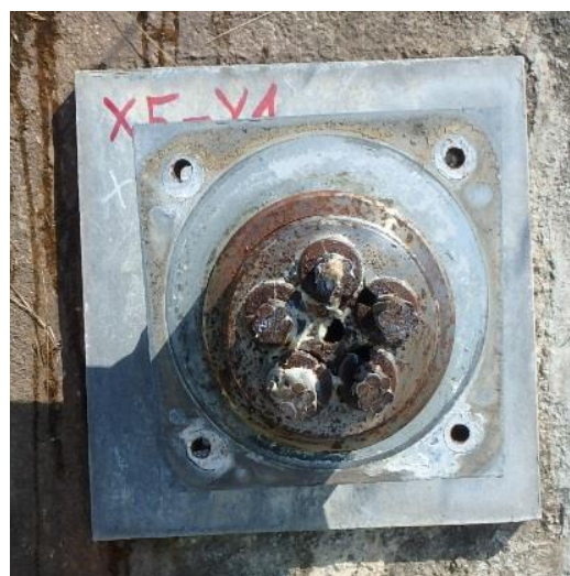
写真-2.5 アンカー頭部の状況(X5-Y4)
