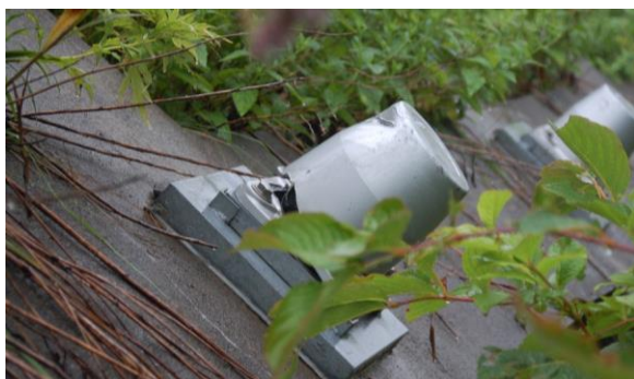
写真-2.1 新タイプアンカーの頭部損傷事例
