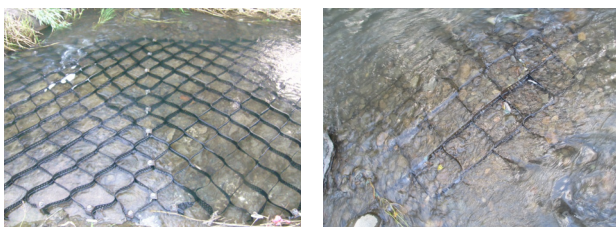
図-27a 出水前後の河床状況（ネットのみ区間） 左：出水前，右：出水後，空のネットに礫が堆積
