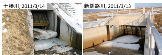
写真-1 冬期河川津波発生後の樋門周辺状況の例
