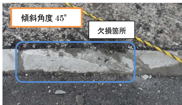
図-6 縁石の損傷状況：モータグレーダ
