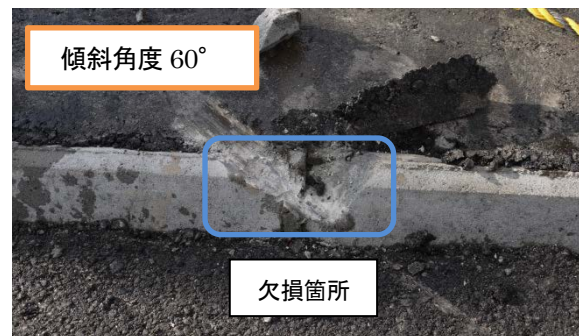
図-5 縁石の損傷状況：ホイールローダ
