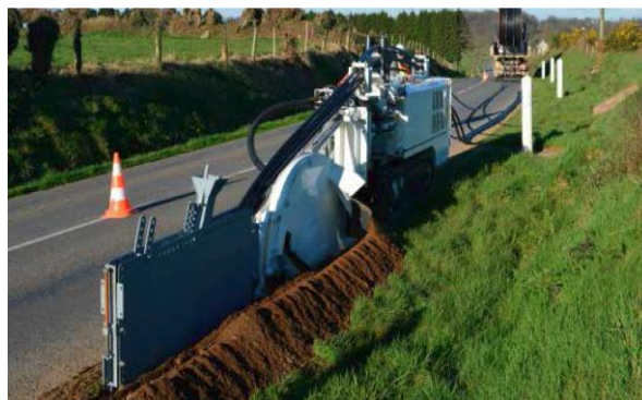
写真-10 海外における専用機械による施工例 ホームページより引用 11)
