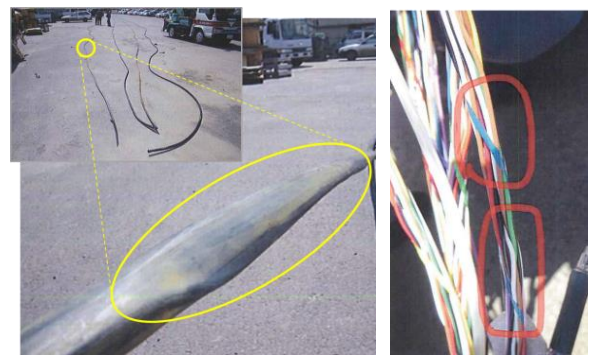
写真-6 通信用メタルケーブルの凍結圧迫・断線事例 (左: 外装の変形 右: 内部ケーブルの接触障害)
