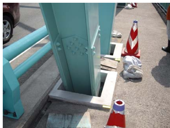
図-1 腐食した鋼部材のボルト接着による補強事例
