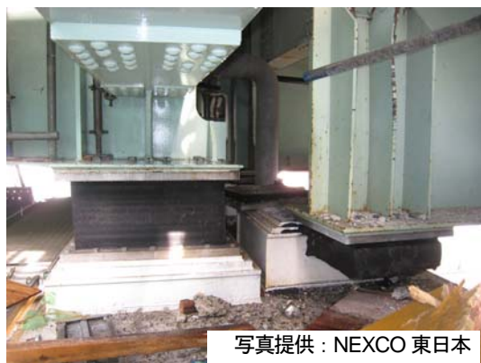
(a) ゴム支承の破断
