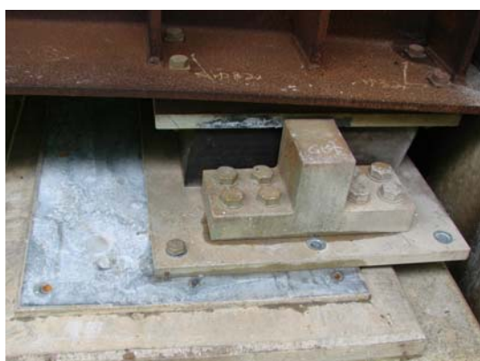
写真-1 A1 橋台の支承部の被害
