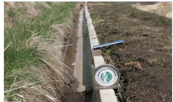
写真-2 切土法面の小段の凍上被害 2
