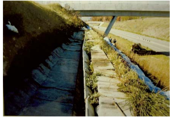
写真-1 切土法面の小段の凍上被害 1
