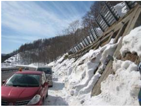
写真-2.3 グラウンドアンカー頭部の変状
