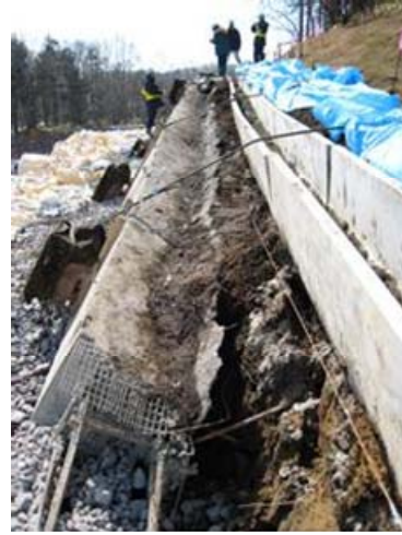
写真-2.2 施工中の法面変状詳細
