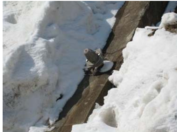
写真-2.4 アンカー頭部の変状詳細
