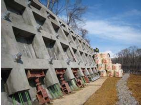
写真-2.1 施工中の法面変状
