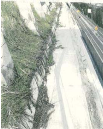
写真-2.5 小段ステップの変状
