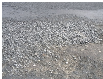
写真-1 排水性舗装の破損状況
