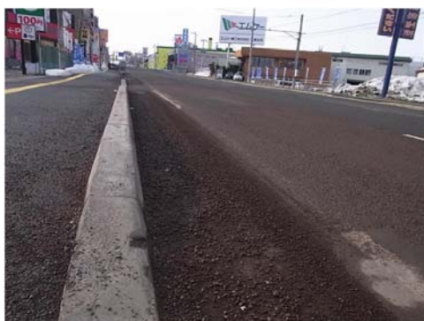
写真-2 除雪車等による骨材飛散
