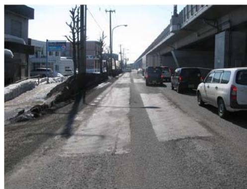
写真-4 車両の発進・停止による破損
