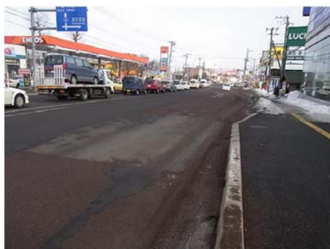
写真-3 車輛の据えきりによる破損
