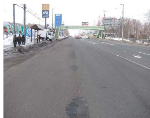
写真-5 施工継ぎ目部の破損
