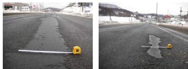
写真-7 施工後5年半経過後の破損状況
