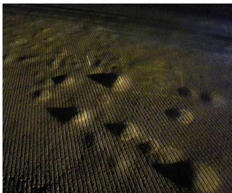
写真-4 対策前ブリスタリング現象の発生状況
