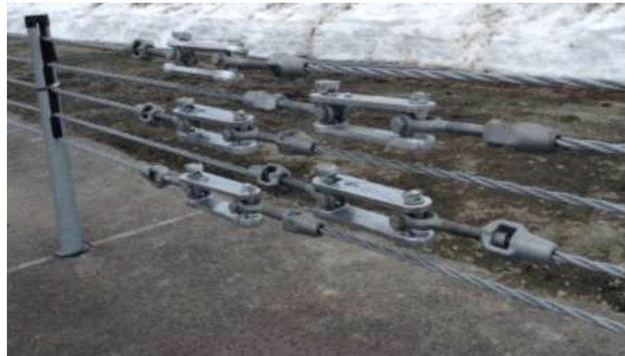
緊急開放金具の設置状況
