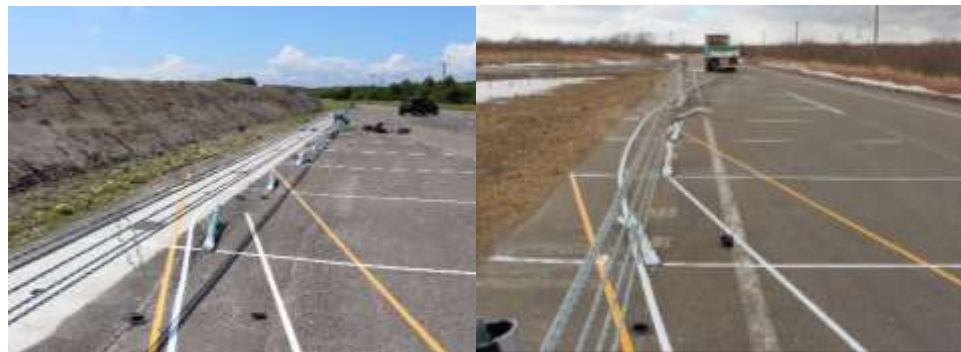
衝突後の防護柵の破損状況(2020年7月, 3月)
