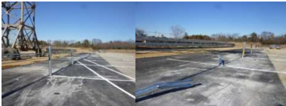
衝突後の防護柵の破損状況(2012年1月)
