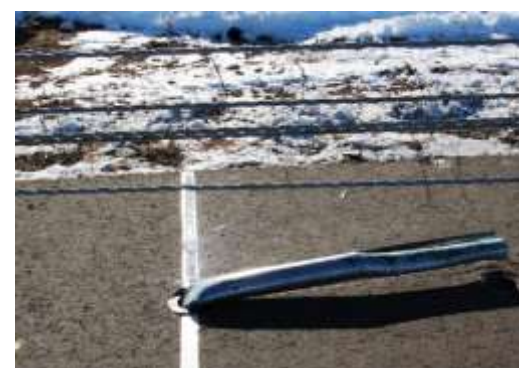
支柱の損傷状況
