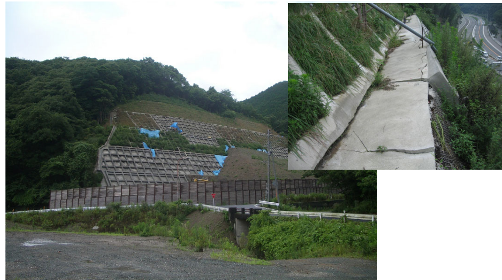
変状が発生した切土斜面 (撮影:平成21年6月)
