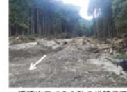
溪流出口での土砂の堆積状況
