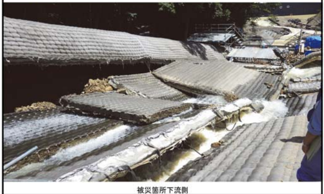
被災箇所下流側
