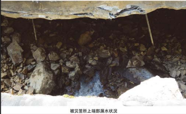
被災箇所上端部漏水状況
