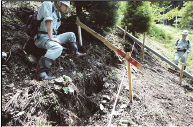
斜面上部で認められた、約100mにわたって連続する亀裂 開口幅20~30cm, 段差30cm程度 13
