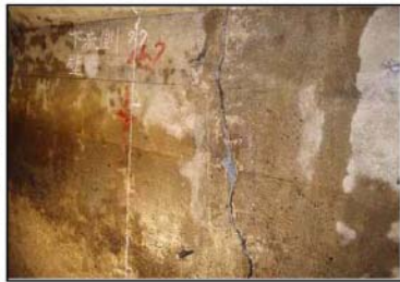
樋門函体のクラック
