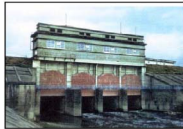
樋門の老朽化
