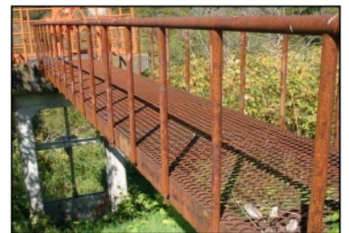
樋門管理橋の腐蝕
