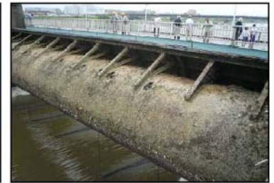
堰ゲートの腐蝕
