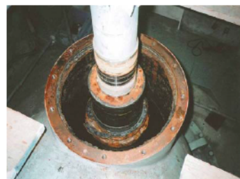
ポンプ主軸パッキンの摩耗
