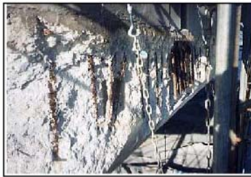
堰本体の鉄筋露出
