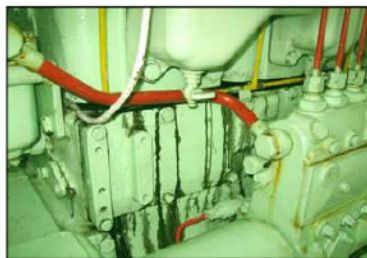
ポンプ原動機からのオイル漏れ
