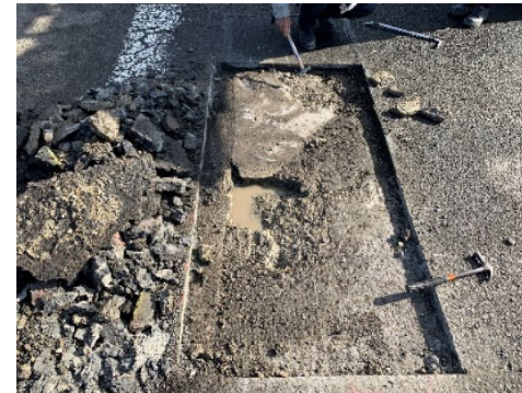
床版の土砂化
