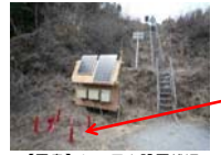
【霧島】システム設置状況
