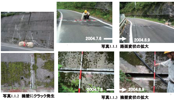
写真1.1.2 擁壁にクラック発生
