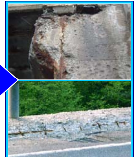
凍害・塩害の複合劣化
