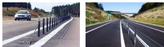
スウェーデン2+1車線におけるワイヤーロープ式防護柵設置状況
