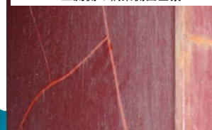
主桁 内面の塗膜われ発生状況
