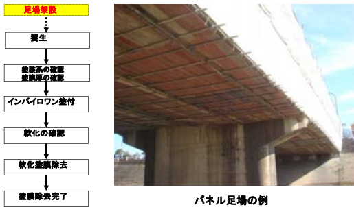
パネル足場の例
