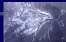
単一のひび割れが交差しブロック化
