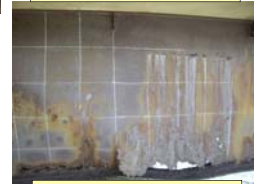
桁端部の破断、座屈
