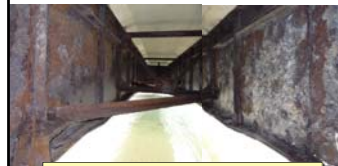
橋梁内部の激しい塩害劣化
