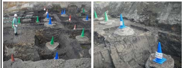
施工不良の例
