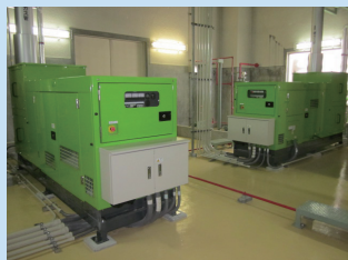
堀之内浄化センターでの設置状況
