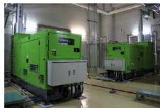
堀之内浄化センター 殿場内
