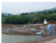
H23.8 奥沢ダム（小樽市） 堤体陥没に伴う排水支援 〔自治体支援〕
