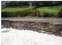
国道1号西湘バイパス(2007.9)
